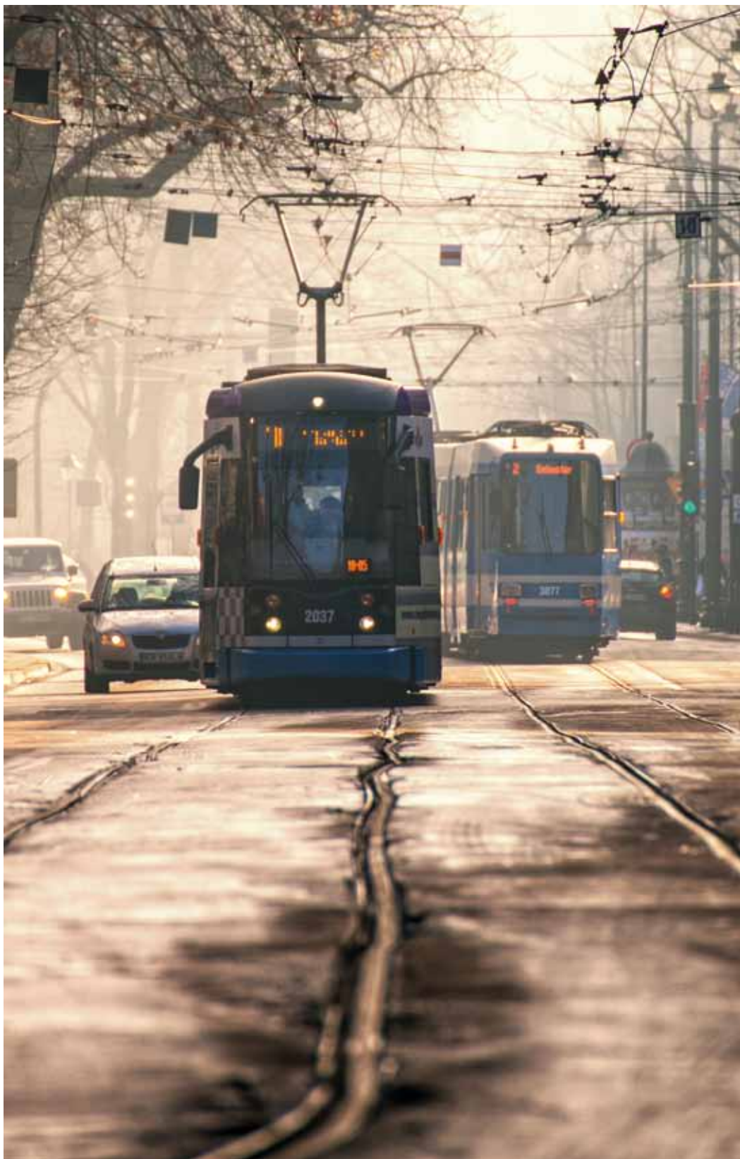
Torowisko w ul. Straszewskiego wymaga natychmiastowego remontu
